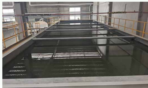
污水处理污泥产生设施斜板沉淀
