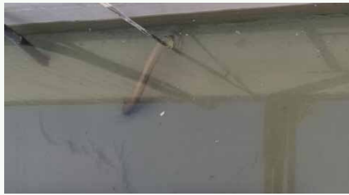
原水池吸泥泵
