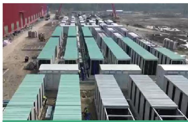
长强钢铁储能项目 25.2MW/243.3MWh
