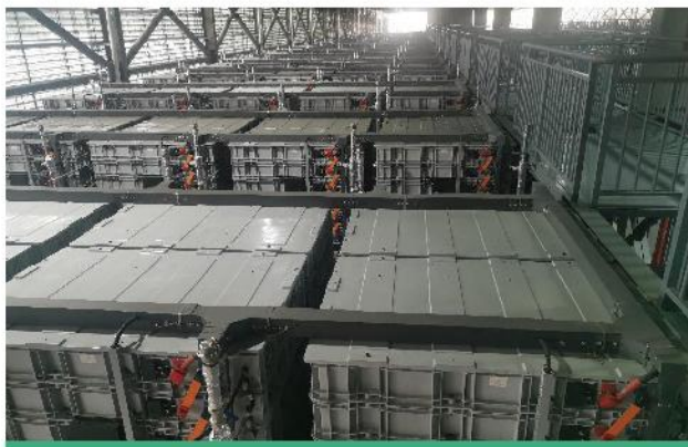
“和平共储” 综合智慧能源共享储能项目 100.8MW/1061.683MWh
