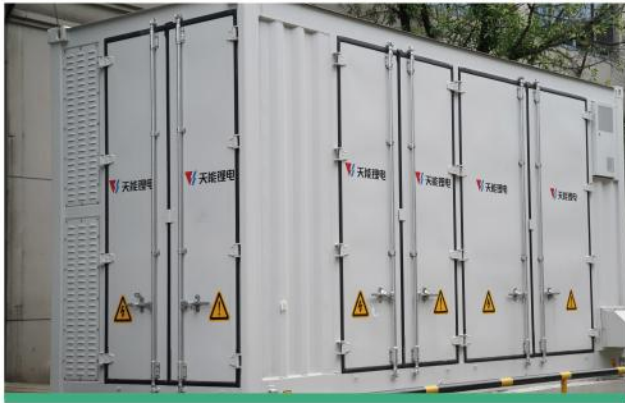
光宇电源储能项目 37MW/148MWh
