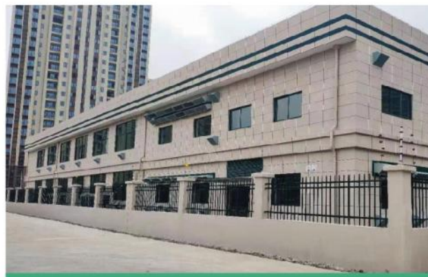
湖州长兴金陵变储能项目 12MW/48MWh
