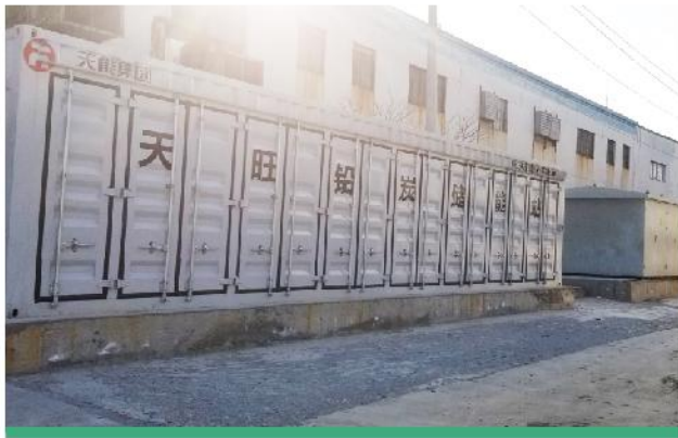
江苏沐阳储能项目 0.6MW/4MWh
