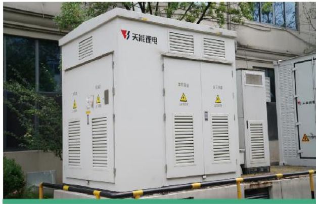
天能集团总部储能项目 5MW/10MWh
