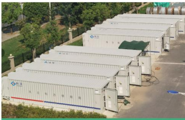
林洋亿纬仙桃储能项目 25MW/50MWh
