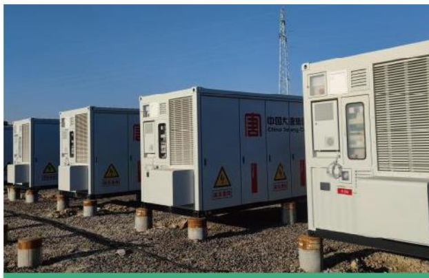
大唐鲁北储能项目 100MW/200MWh
