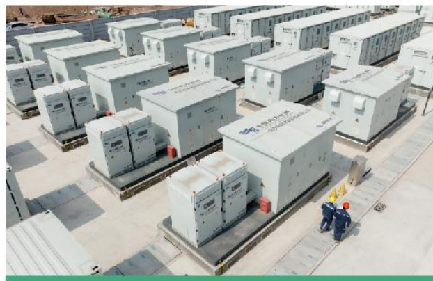
南方电网城北站储能项目 15MW/30MWh
