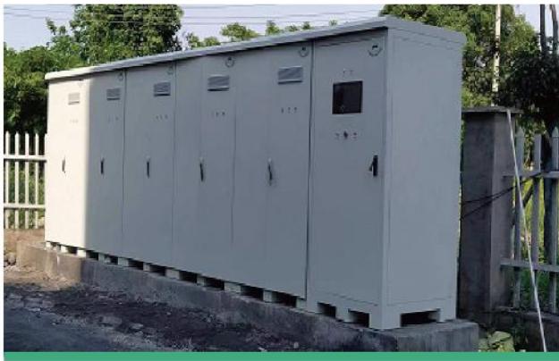
美欣达集团储能项目 1MW/2MWh
